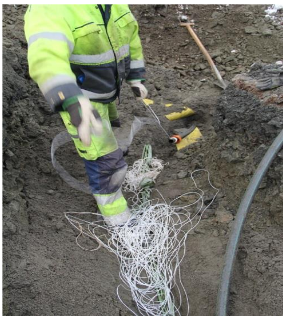
Trassel i matarrör från Viareds telefonstation
